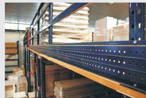
Rodapié: ubicado en todo el perímetro de la entreplanta y evita la caída de pequeños objetos.
